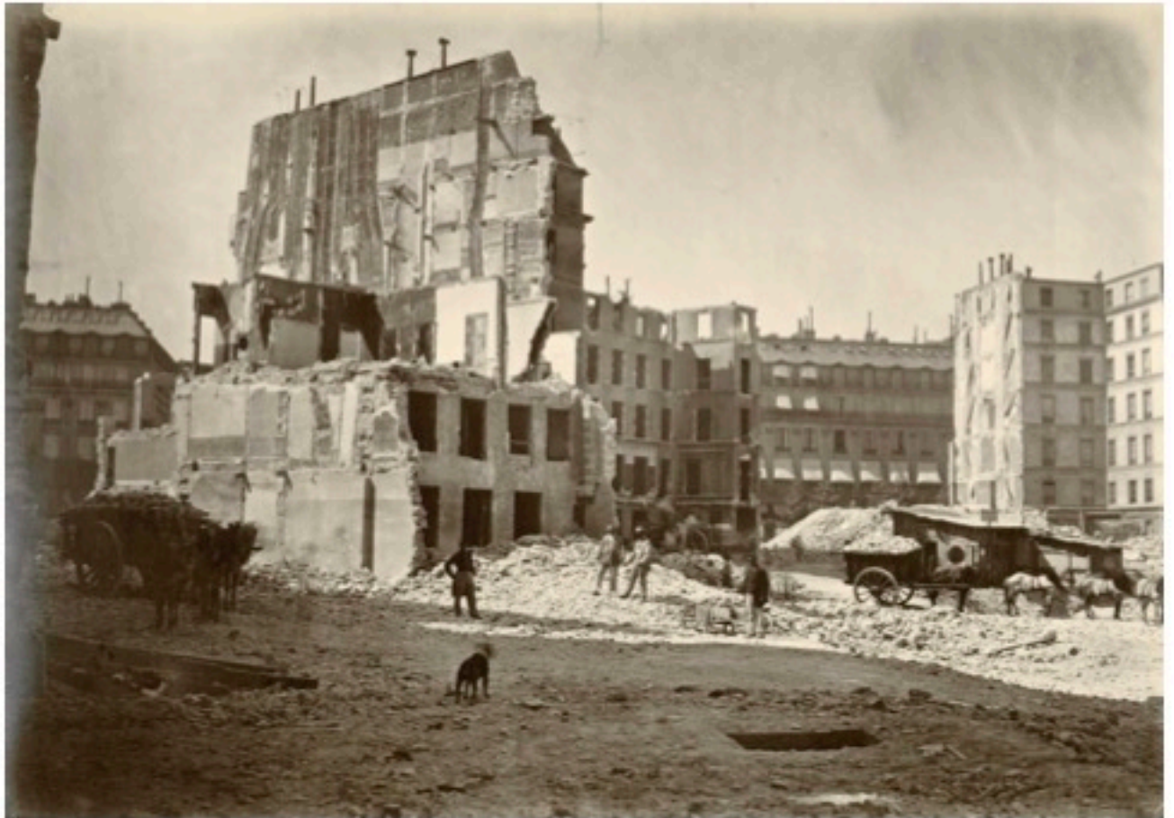
85. Construction de l'Opéra Garnier à Paris, déblaiement de l'avenue Hyacinthe-César Delmaet (1828-1862), Louis-Émile Durandelle (1839-1917) Service des collections de l'Ecole Nationale Supérieure des Beaux-Arts
